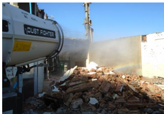
Fig. 6 Dust Suppression in use.
